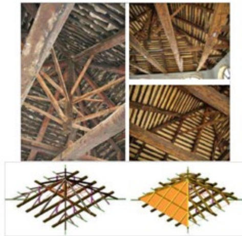
Figure 9 - Domodossola (Italy), Castle Tower, an example of consolidation of the pavilion roof with struts and ties. (From L. Jurina, Tecniche di consolidamento dei monumenti. Una panoramica attuale , Pisa 2012)
